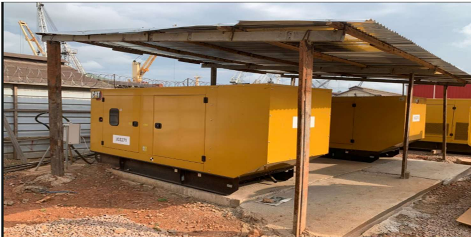
Photo n°4 : Abri pour groupe électrogène
